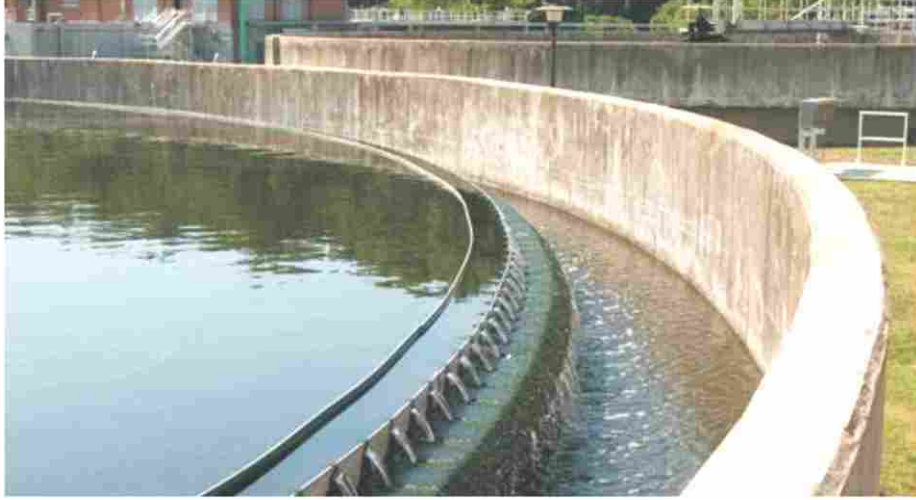
चित्र 18.5 जल शुद्धीकरण टंकी (Water Clarifier)
